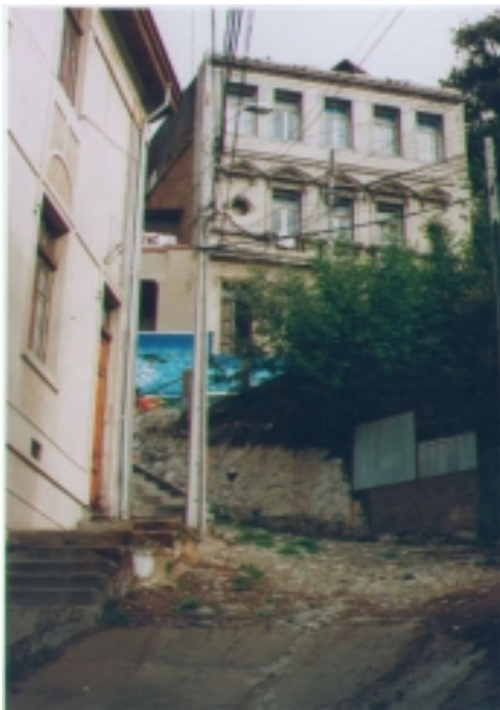
( 1 ) Vista de espacio balcón en el acceso norte del Museo antes de la rehabilitación. Se observa el deterioro espacial y el grado de inseguridad ambiental.
